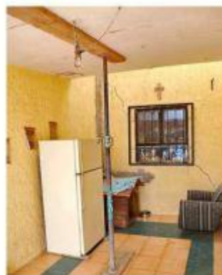
■ Casas de Pedro Loza padecen de cuarteaduras. Algunas están apuntaladas.
